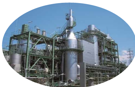
清瀬水再生センター 下水汚泥ガス化炉（東京都）
